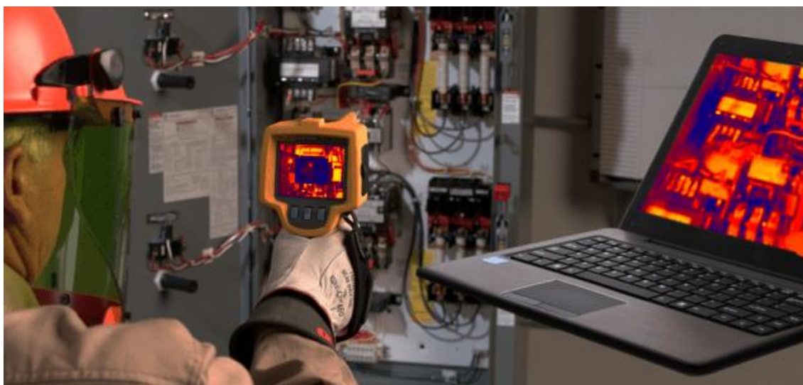
Рисунок 20. Пример проведения тепловизионного контроля электрошкафа
